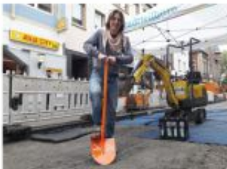
Die Regenwasserkanäle sind nicht, aber es ist immer noch ein bisschen gefährlich. Bitte, die die sind überwinden durch geeignete Maßnahmen (z.B. durch einen Schutzzaun, durch eine Absperrung).
